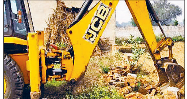
कनीना। अवैध निर्माण हटाती डीटीपी की टीम। फोटो: हरिभूमि
